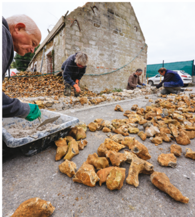
Chantier participatif de construction d'un muret en silex à Hervelinghen Photo Eric Desauinois
